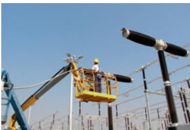
Stazione AT 380 kV / HV 380 kV station
