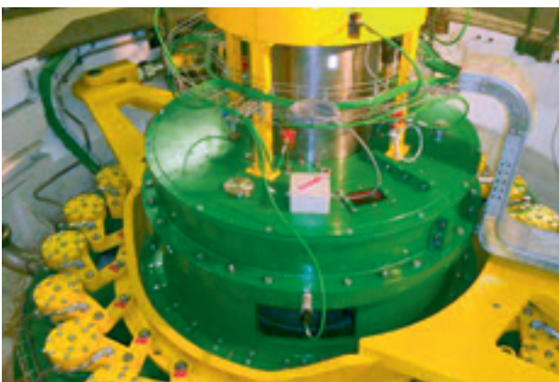
Centrale elettrica Somplago (UD) / Electrical power plant Somplago (UD)
