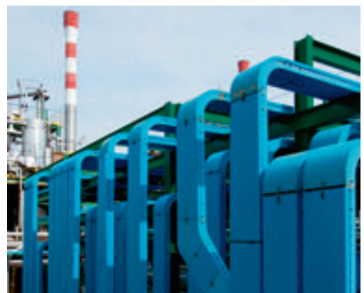
Impianto di distribuzione elettrica per industria chimica Polynt Electric distribution plant in Polynt chemical sector production plant
